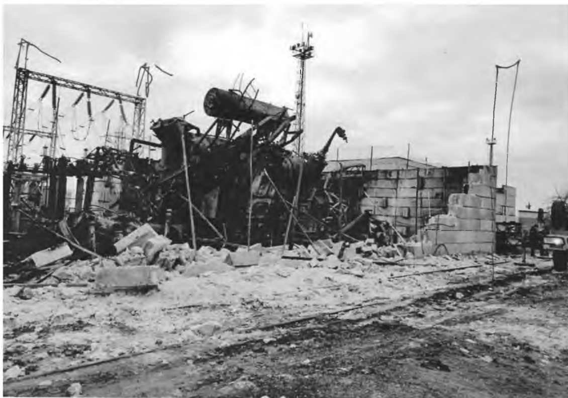
Рисунок IV.1 - Разрушение трансформатора ПС 330 кВ Макеевская от ударов артиллерии ВСУ
